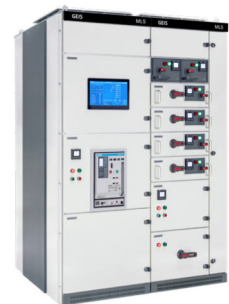
MLS LV Switchgear
